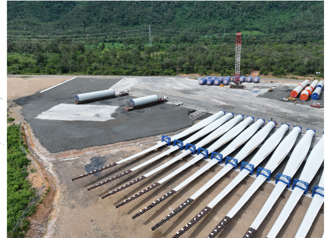
建設が進む風力発電設備
