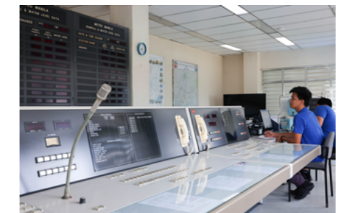
「パッシング洪水予警報システム事業」(円借款)で整備されたロサリオ中央制御ステーション。ロサリオ せき 堰の開閉を判断することで河川水量を適切にコントロールし、併せて放水開始を付近にアラートする。
