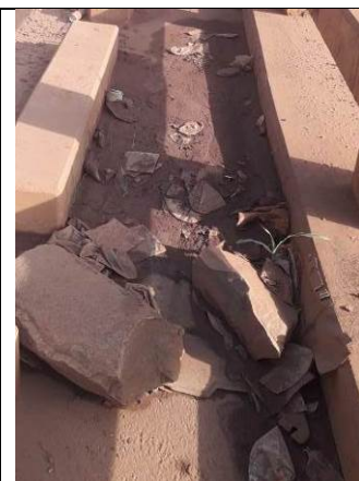
歩道に残置された廃棄物
