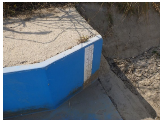
本事業で設置した水量計
