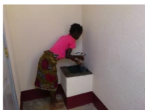
目隠し壁の内側に設置された手洗い用水栓
