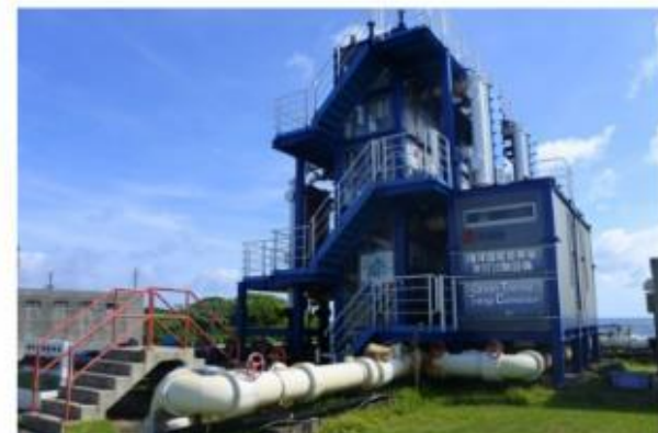
図1 ●沖縄県の久米島で稼働する海洋温度差発電の実証設備
