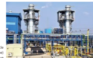
Projet de centrale à gaz à cycle combiné de Maputo (Mozambique) Photo : Electricity of Mozambique
