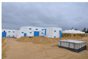
Réservoir 1000m 3 , Station de pompage et transformateur
