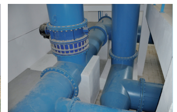
Chambre des vannes de réservoir 5000m 3
