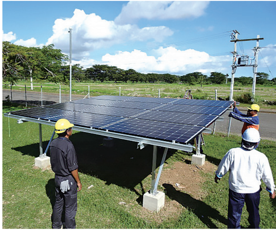
フィジーに設置された訓練用の太陽光発電設備
