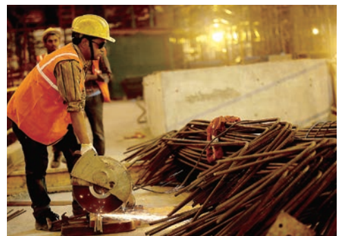
工事現場では事故が起きないように細心の注意を払います
