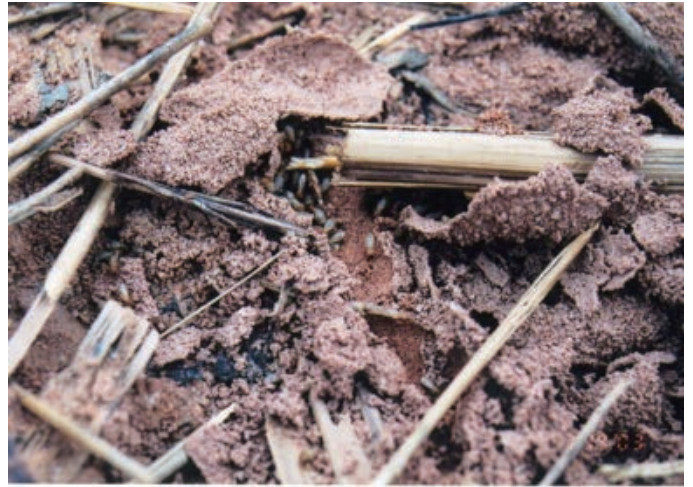
写真3 シェルターをこわすと、蟻道があり、多数のシロアリが見えます(2003年7月19日)
