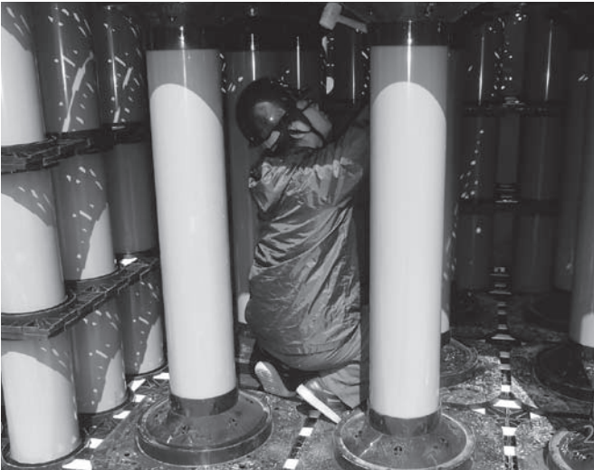
ユニバーサル地下貯留システム。作業員が内部に入り、点検・整備ができる点も大きな特徴だ。円筒形のプラスチック部材が雨水貯留材「アクアパレス」
