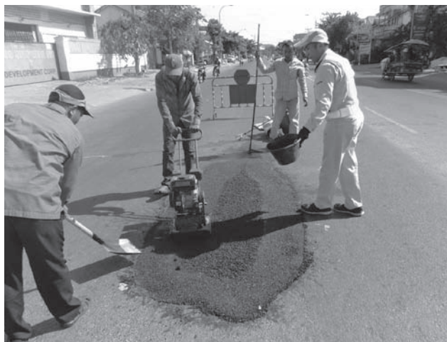
交通量の多い2号線の損傷箇所を緊急補修するためEXCELをプレートコンパクトで転圧。EXCELは雨の中でもスコップなど簡易な道具で舗装補修ができる全天候型の簡易常温舗装補修材だ
