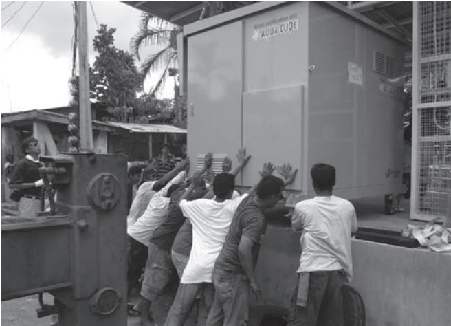
浄水装置「アクアキューブ」を設置するネグロス・オクシデンタル州サガイ市の住民たち。浄水装置、発電、貯水タンクなどをオールインワンで内蔵しているため、水源にポンプをつなげるだけで安全な飲料水を製造する
