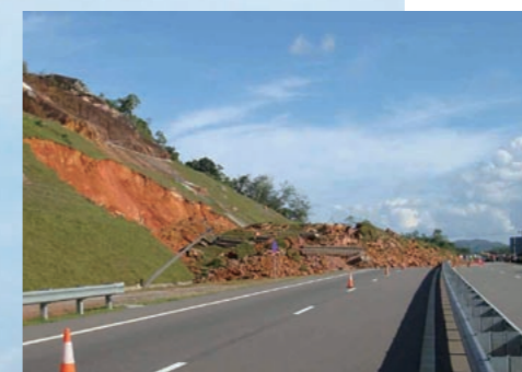
2012年11月、南部高速道路で発生した土砂崩れ。RDA職員が事前に斜面の亀裂を発見し、道路を封鎖したため難を逃れた
