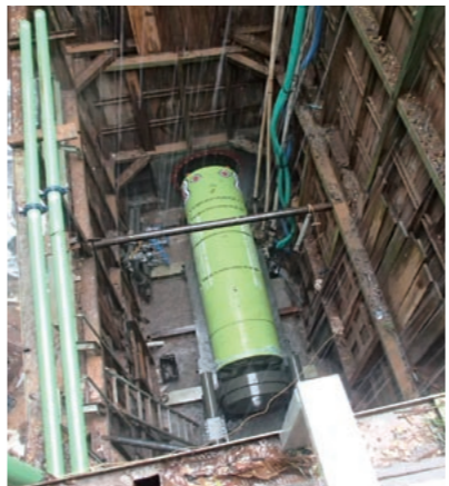
掘り進めるスタート地点に設置された掘進機。「文化の違いを理解しつつ、工事を進める際の安全管理はしっかり教えています」と佐々木さんは話す
