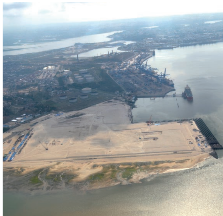
奥に見えるのがモンバサ港の既存のターミナルで、手前が建設中の新ターミナル。今後さらに拡張する計画だ（提供：東洋建設株式会社）
