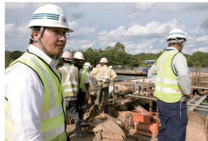
南部高速道路の建設を率いる堀川さん。現場は地盤がゆるく、技術的に苦労も多かった（撮影：谷本美加）
