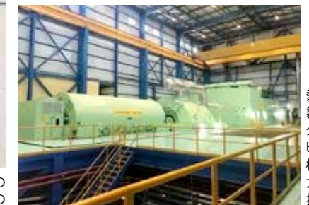
熱効率の高い日本製の最新鋭のガスタービン、蒸気タービン、発電機。1号機と合わせ、国の電力需要の約1割を担っている。
