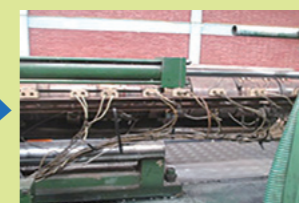
カイゼン後。機械の油汚れなどがなくなり、配線もきちんとまとめられています。
