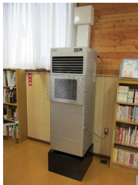
図 51 厚田小学校に設置されたペレットストーブ
