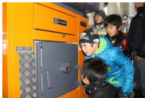
図 55 木質チップボイラー
