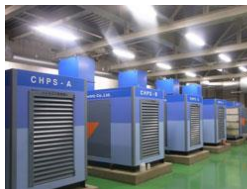
図 35 バイオガス発電機
