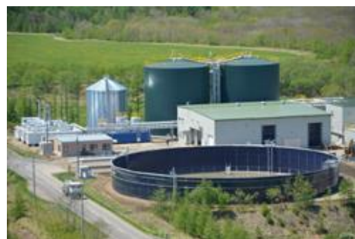
図 47 別海バイオガス発電施設 外観
