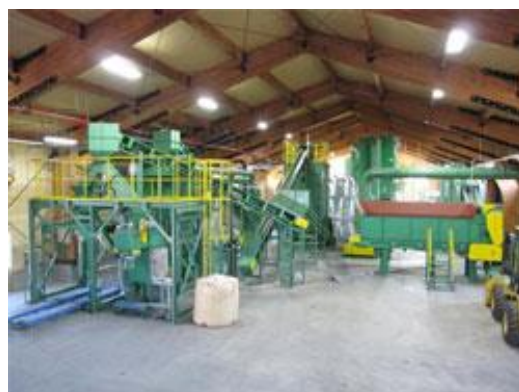
図 37 ペレット製造施設
