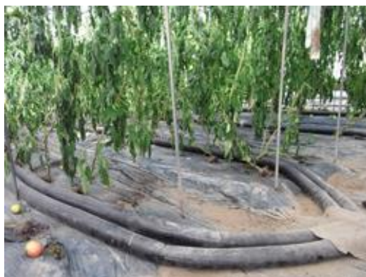
図 40 ハウス内の加温水配管
