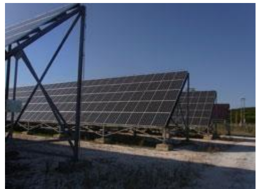
図 29 稚内メガソーラー発電所
