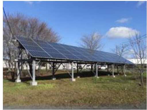
図 64 太陽光発電システム
