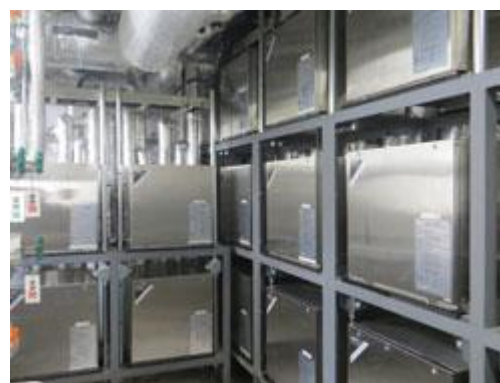
図 31 町民センターの熱交換機
