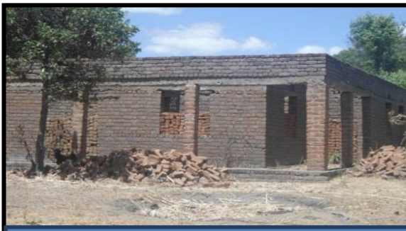
Boma la ofisi ya Kijiji cha Bubutole jengo ambalo halijakamilika
