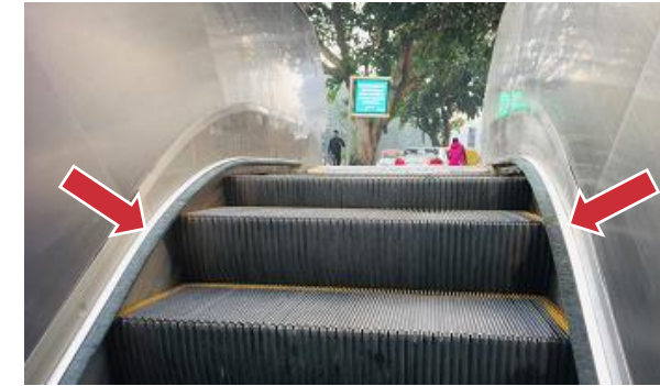
駅のエスカレーターには、インドの女性が着る裾の長いサリーが巻き込まれることを防ぐブラシ「サリーガード」が付けられている
