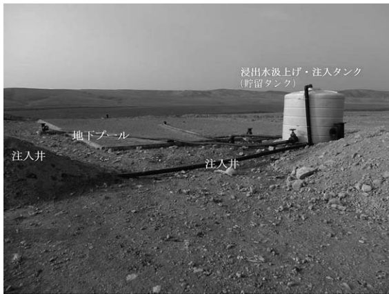
写真-5 マヤメイ処分場の浸出水循環システムの注入サイト全景 (2013年11月)
