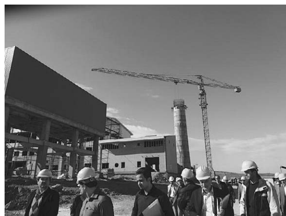
写真-2 テヘラン市郊外のごみ焼却・発電施設建設現場 (2013年11月)
