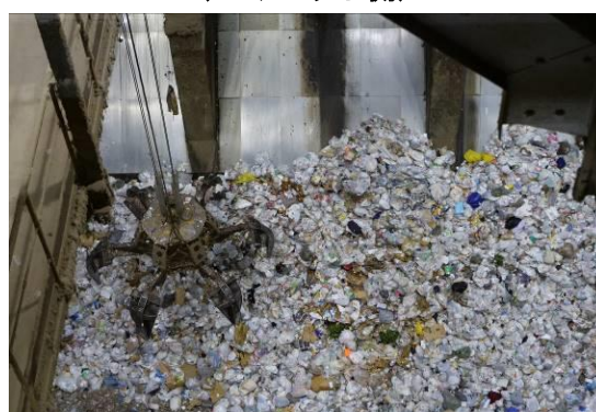
写真 4-37 ②ごみピット
