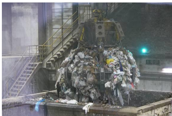
写真 4-38 ③ごみクレーン
