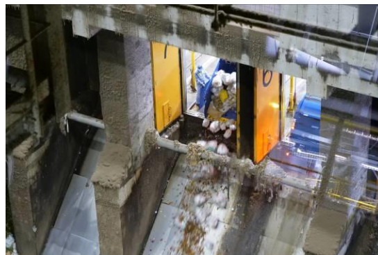
写真 4-35 ①プラットホーム (ごみピット側)
