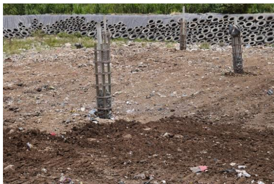
写真 4-73 福岡方式処分場ガス抜き管
