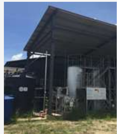
本プロジェクトで既存のパーム油搾油工場に設置・運転、研究活動を実施しているゼロディスチャージ・モデルプラント（廃蒸気の再利用～排水の浄化、炭化設備、コンポストの精製設備）
