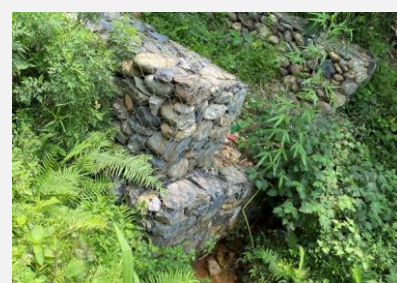
蛇籠でつくられた小規模チェックダム
