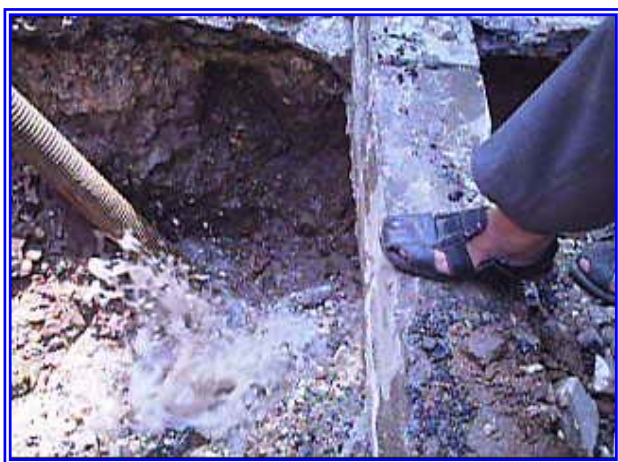
写真1 配水管網の漏水現場
