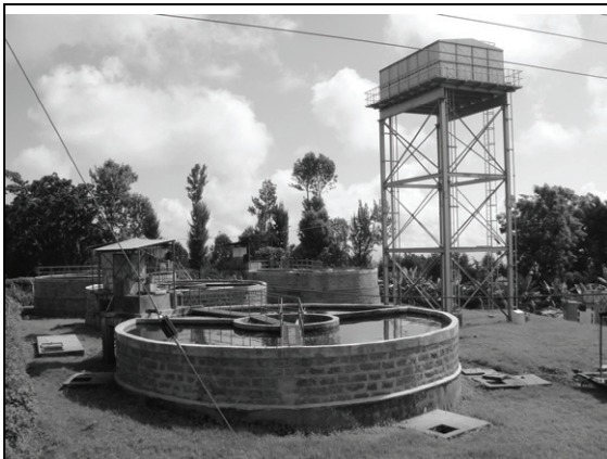
メルー上下水道信託会社(MEWASS)の浄水場にある凝集・沈澱・濾過池
