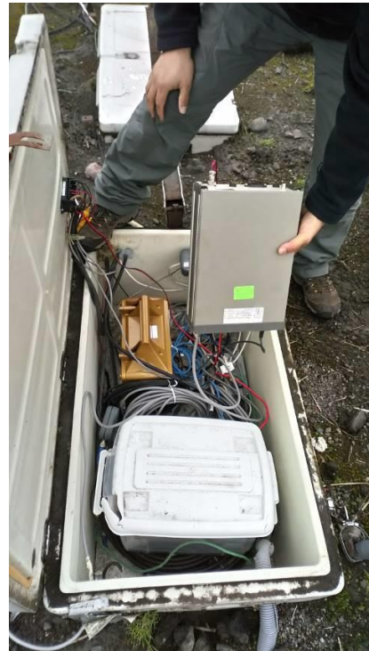
地面に埋め込まれたケースの中に設置されている機材
