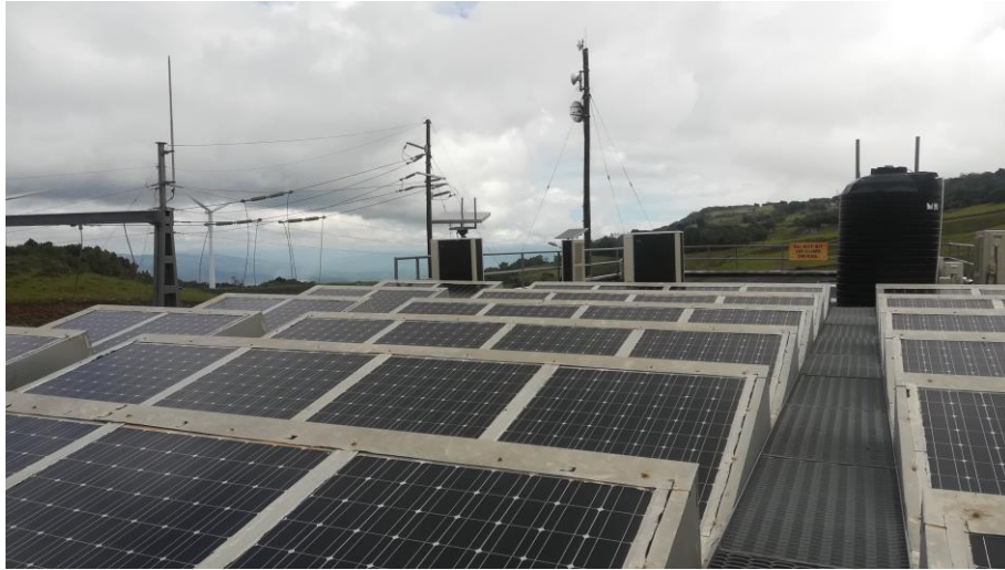
ベースライン調査で赴いた太陽光発電所（ジャマイカ、マンチェスター教区）
