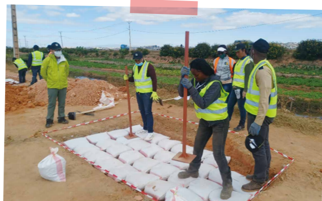
マダガスカルでの土のうを用いた路面強化実習の様子
