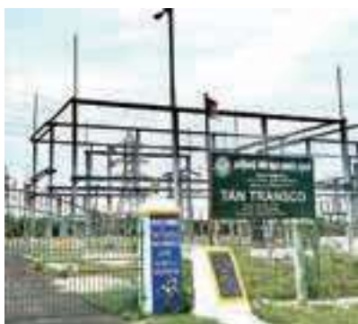
タミル・ナド州、日本企業開発主導の工業団地において JICA 円借款にて変電所を整備
