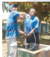
Asistencia en sistemas de bombeo para Puerto Cabezas
