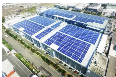
屋根置き型太陽光発電設備
