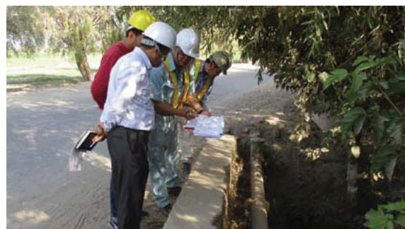
水管橋の施工完了検査を行う、梅原さんの同僚の服部さんと、ピアンジ上下水道局のスタッフたち
