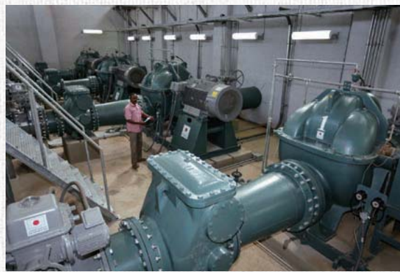
日本の支援により建設された灌漑ポンプ場。ナイル川から水をくみあげている
