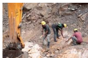
ネパール地震復旧・復興プロジェクトにおける橋の建設現場（撮影：中村年孝）
