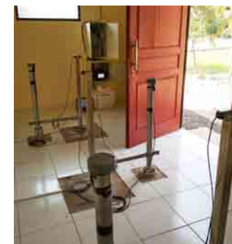
観測井戸。1か所につき深さの異なる3本の井戸を建設している。各井戸は二重構造になっており、地盤が沈下するとその分だけ内側のパイプも沈む。3本の井戸のパイプの沈み具合の差で、各地層での収縮の度合いを計測する。
