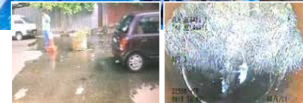
左：下水管の損傷により、水が溢れ出しているクアラルンプールの道路。右：損傷の原因の一つは木の根の侵入。写真は下水管の中に入り込んだ木の根の様子。
