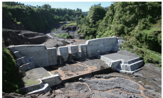
Bendungan Sabo yang dibangun di kaki Gunung Merapi (Foto: Yachiyo Engineering Co., Ltd.)
