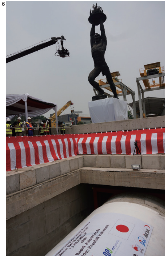
6: Pembangunan MRT dengan Teknologi Mutakhir Jepang Dalam proyek MRT sebagai kereta bawah tanah pertama di Indonesia, menggunakan konstruksi Tunnel Boring Machine produksi Jepang. (Foto: JICA)
