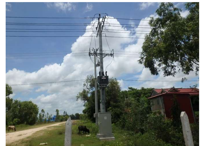
設置した柱上変圧器(バベット)
