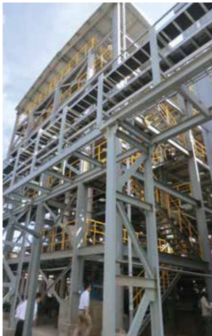
排水処理施設建屋(一部)
