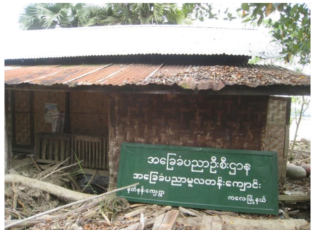
洪水により倒壊した小学校建物。ザカイン管区カレイ地区ナンナン・タウンシップ。
