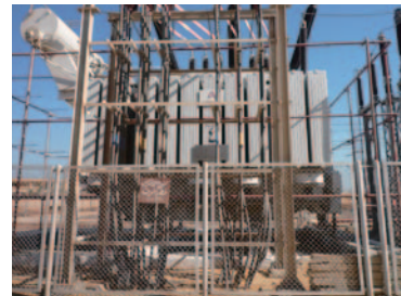
本事業で増設された変電設備
