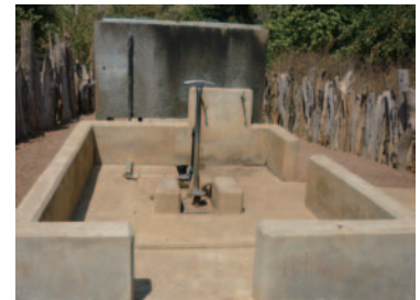
除鉄装置付き足踏みポンプ付き深井戸給水設
