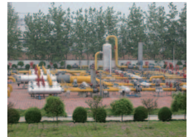
メインパイプラインから天然ガスの供給を受けるゲートステーション（駐馬店市）
