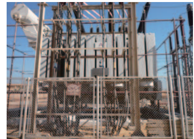
本事業で増設された変電設備
