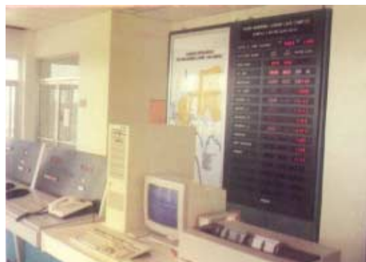
ロザリオ中央監視施設
