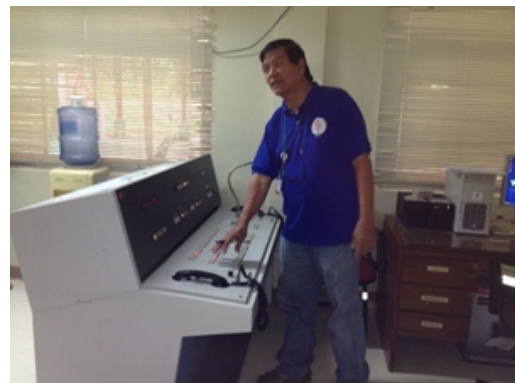
写真 5：San Roque ダム 予警報装置
