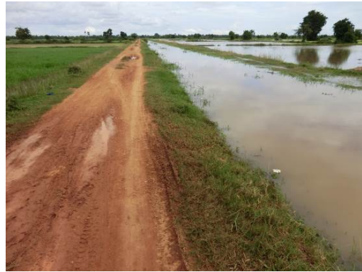
写真 10: Por 灌漑水路。左の TSC3 モデルサイト側の堤が対岸の堤よりも高いため、モデルサイトの外となる右側圃場の冠水が著しい。これらの圃場では雨期の稲作ができなくなった。
