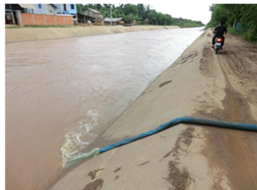
写真 1:2000 年初頭に無償資金協力により補修された 1 次水路。近傍の圃場ではポンプを用いて 1 次水路から直接取水したり配水したりしている。農民の最大の要望は堤の道路機能の整備である。
