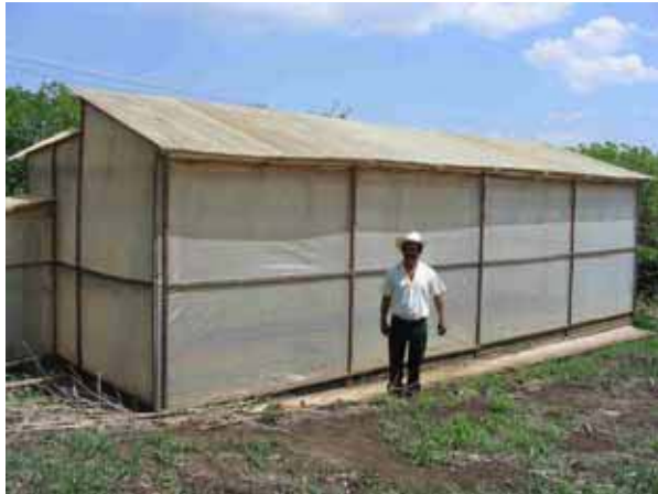
写真 3-1 拠点農家がプロジェクトの支援を得て建設した育苗ハウス
