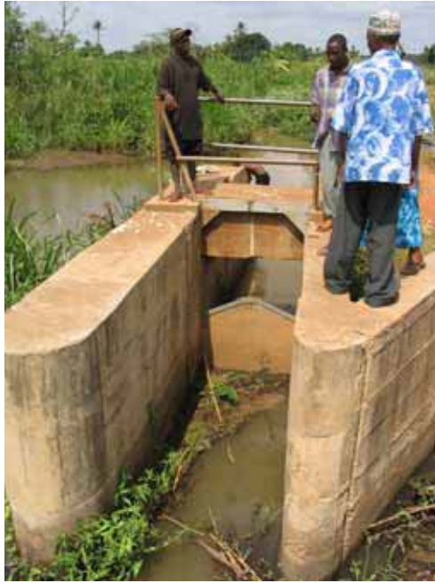
写真 4-7 農民組織による管理が不十分で壊されてしまった頭首工（マヘンゲ）
