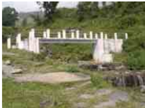
⑧ サブプロジェクトによって作られた橋。護岸工事もおこなわれた。（ワード6）
