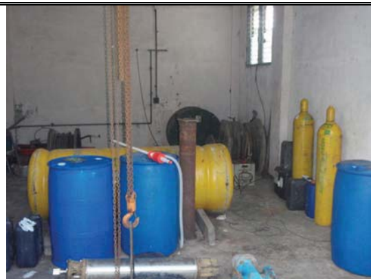
同左:施設視察 塩素消毒用のガス・ボンベ貯蔵室
