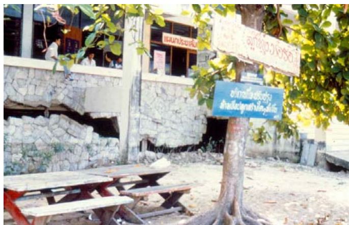
図 3.2 不同沈下に起因する構造物の被害事例
