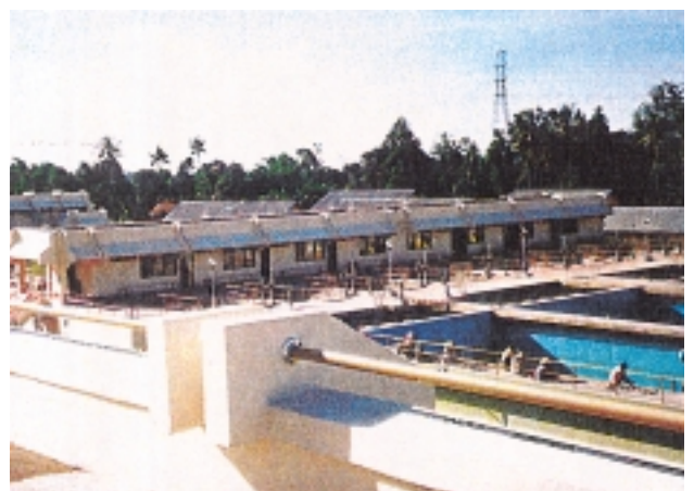
完工間近のソンパ・オブ浄水場(2000年2月時点) (ウジュンパンダン市水道整備計画)
