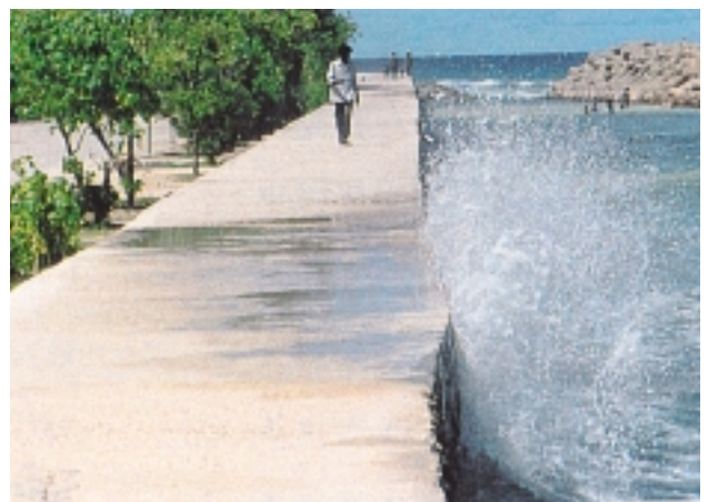
離岸堤開口部付近の護岸は波の侵入が大きく、護岸の破損の要因となっている
