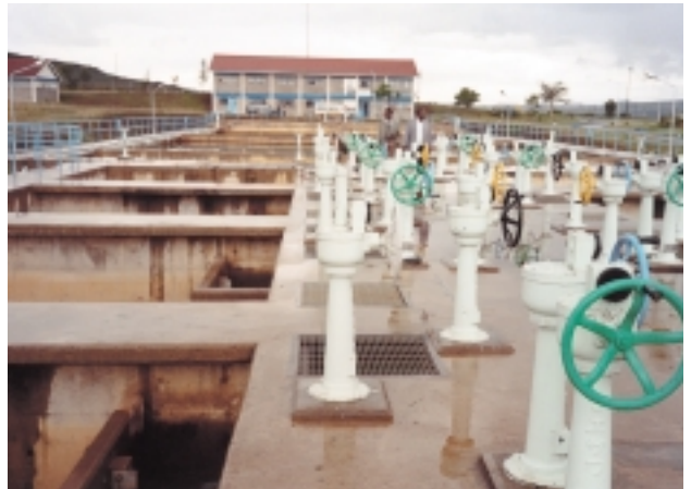
大ナクル地区水供給計画の浄水場（円借款により建設）
