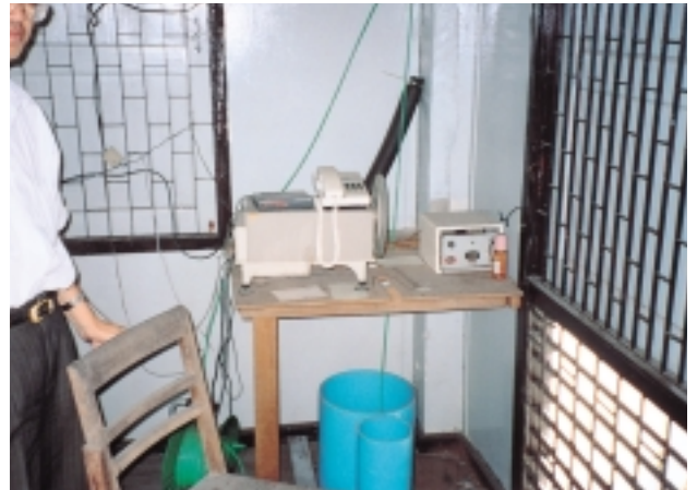
タイ「チャオピア川流域水管理システム及び監視計画」計画で提言された通信・監視システム改良事業に基づいて建設されたバンサイ監視所
