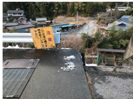
設置された合併処理浄化槽
